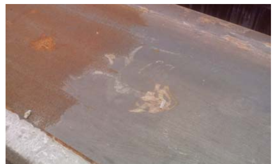
⇒ Figura 7.- Diferencia entre una zona tratada con recubrimiento de protección para intemperie en base agua y otra zona no tratada tras dos años de exposición (Zona centro peninsular).
