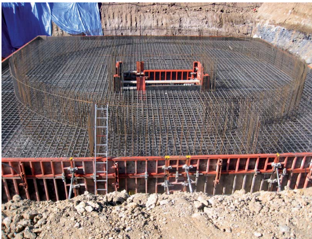
Figura 8.- Vista general de la losa de cimentación de la torre de control del aeropuerto de Barcelona.
