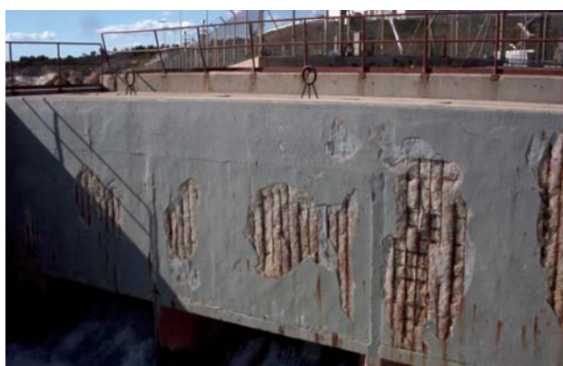
Figura 1.- Efectos de la corrosión en un elemento de hormigón armado.
