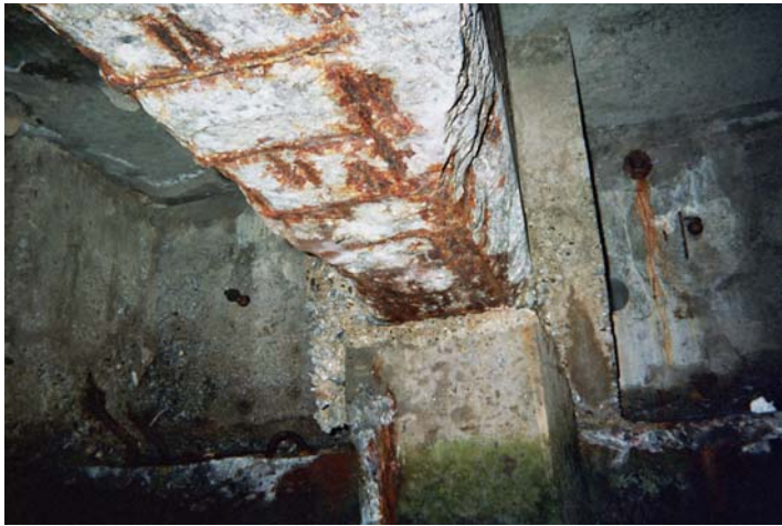
Detalle del daño
