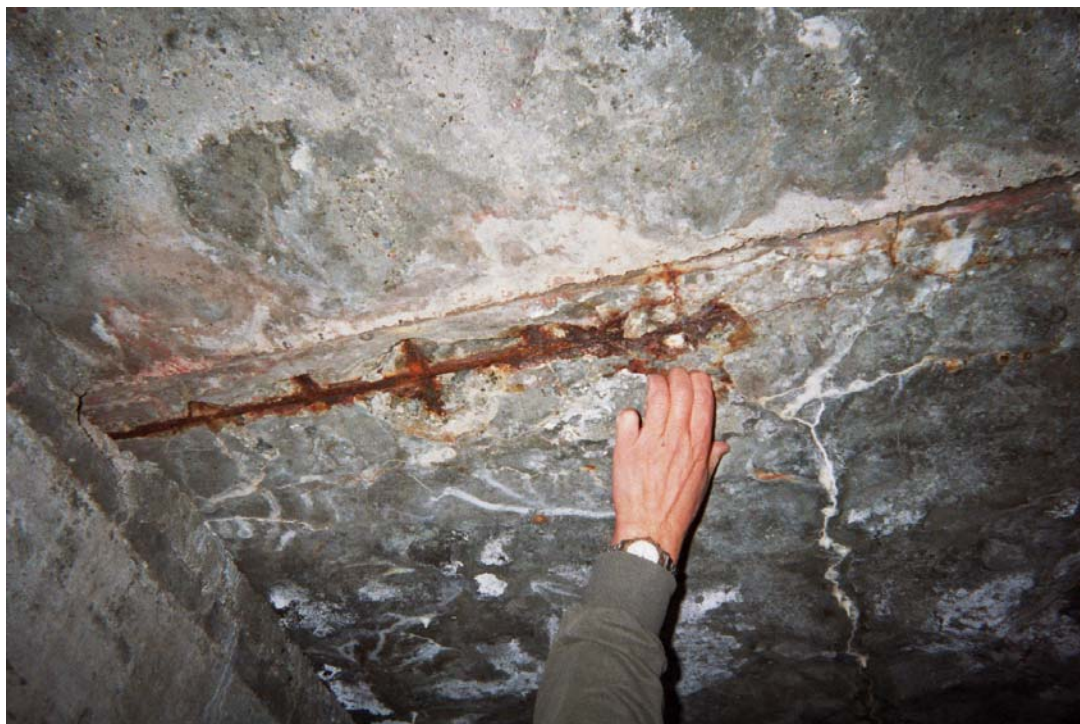
Imagen en la que se comprueba la facilidad para desprenderse el material.
