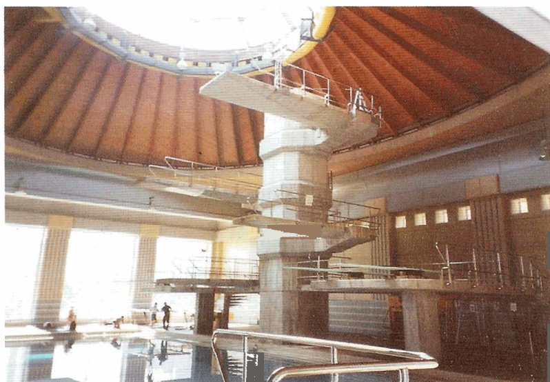
Con el paso de los años, el trampolín había sufrido un ataque corrosivo
