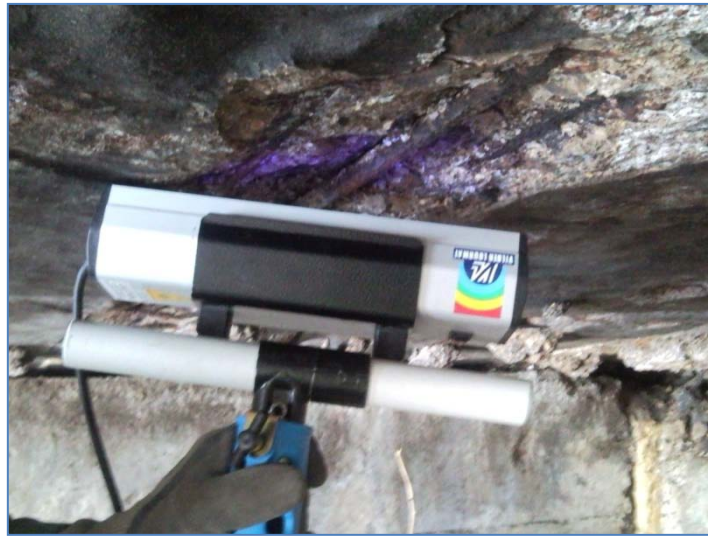
14.- Momento de la visualización de un inhibidor de corrosión migratorio en superficie mediante el uso de una lámpara UV.
