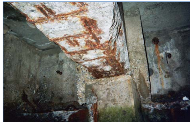
5.- Ejemplo de corrosión en hormigón armado.
