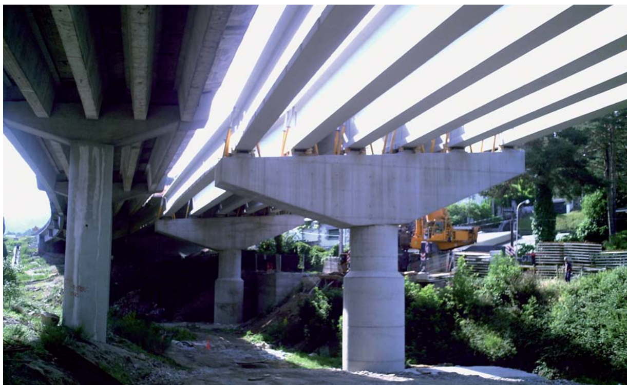
➡ Fotografía 3.- Aspecto de una estructura tras la aplicación superficial de los inhibidores MCI (Autopista de peaje A-6).
