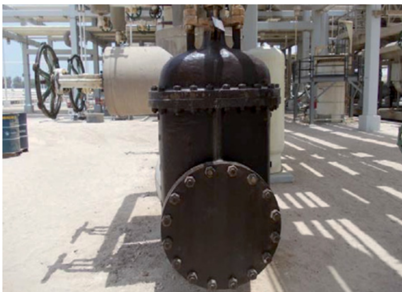
FIGURA 3. Protección temporal en una válvula
