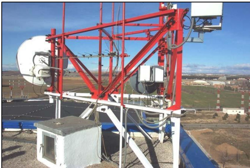
Aspecto final de las antenas
