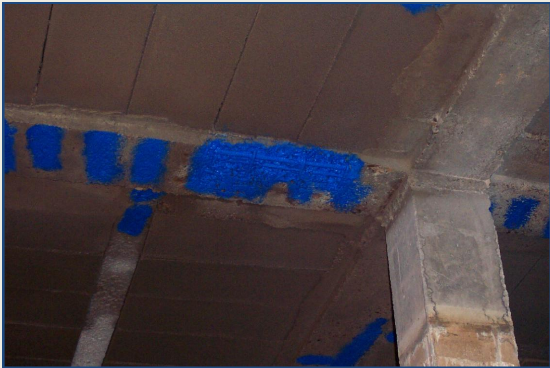
Detalle del daño causado por la corrosión.
