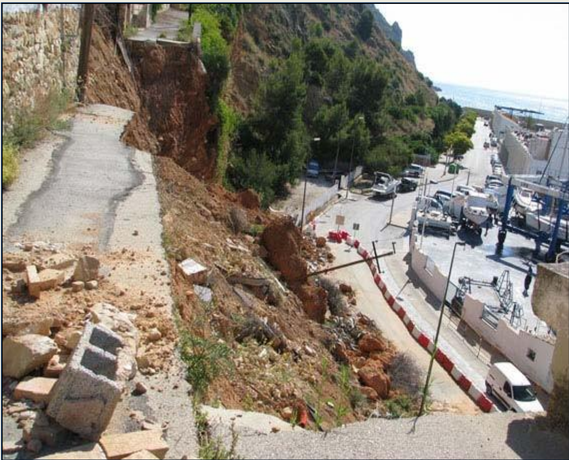
Detalle del desprendimiento.
