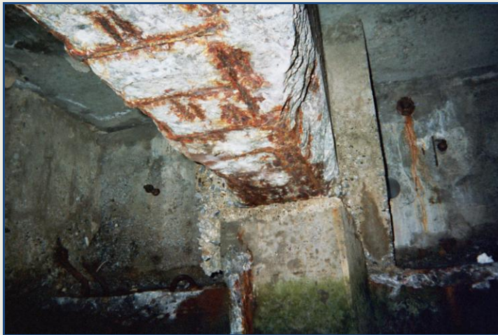
Detalle del daño
