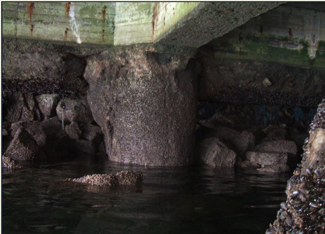
Imagen en la que se comprueba el daño sufrido por el material.
