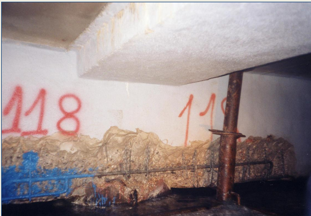
Detalle del daño causado por la corrosión.
